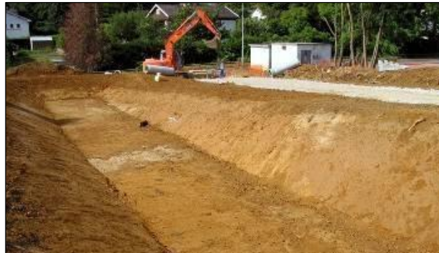
Figure 6 : Exemple de mise en place d'un bassin de rétention des eaux pluviales
